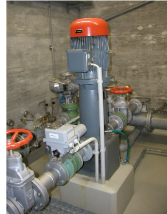
Trinkwasserpumpe / Turbine Schönenberg
