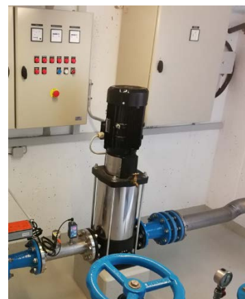
Trinkwasserpumpe / Turbine Gurtberg
