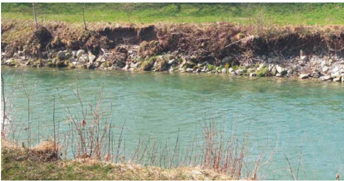
Beispiel für erodierte Böschung
