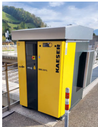
Neues Gebläse der ARA Wattwil
