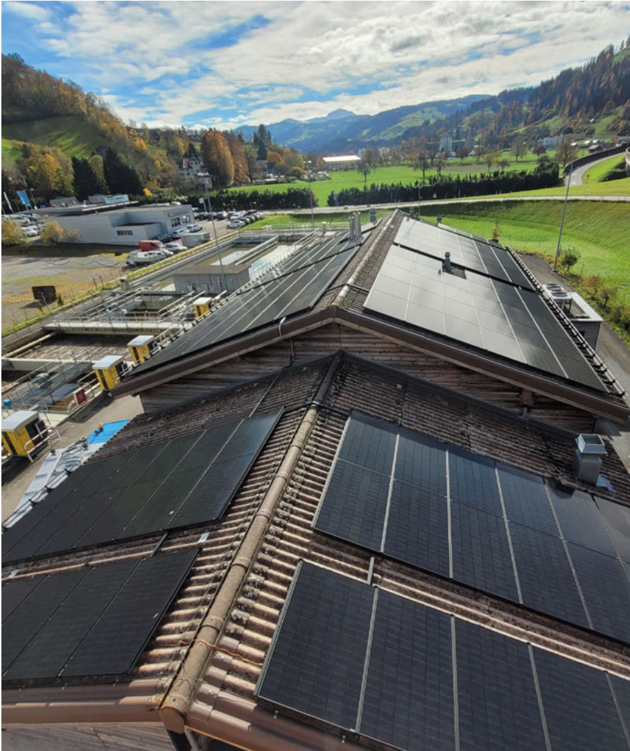
Photovoltaikanlage auf dem Betriebsgebäudedach der ARA. Bild: zvg
