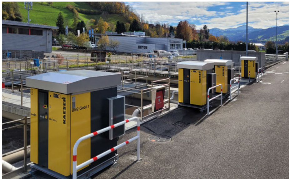
Die neuen Gebläse in Betrieb. Bild: zvg
